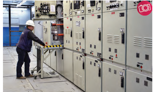
Fig. 22. Centrală electrică – interior cameră de control
