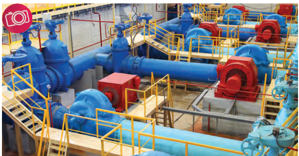
Fig. 3. Stație de pompare
