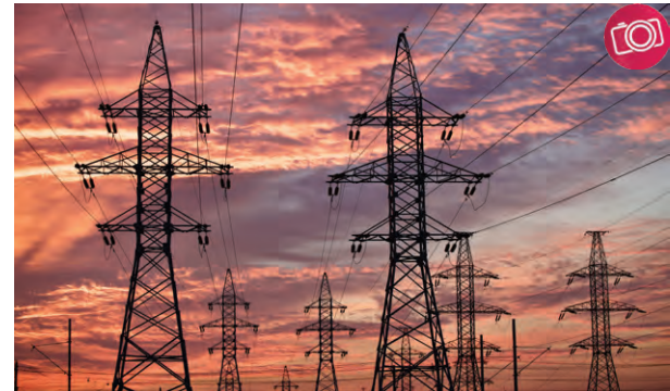
Fig. 23. Linii electrice aeriene
